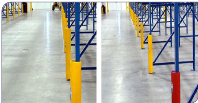
شکل ۳-۳. حفاظت از پایه‌های قفسه‌ها
